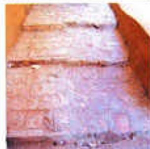
La remise en place des pavés d'une manière désordonnée.
