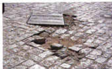
Un pavement détérioré en raison des infiltrations internes.
